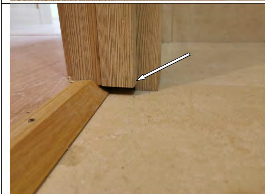
Фото №59. Коротко подрезана коробка дверного блока в ванной комнате.
