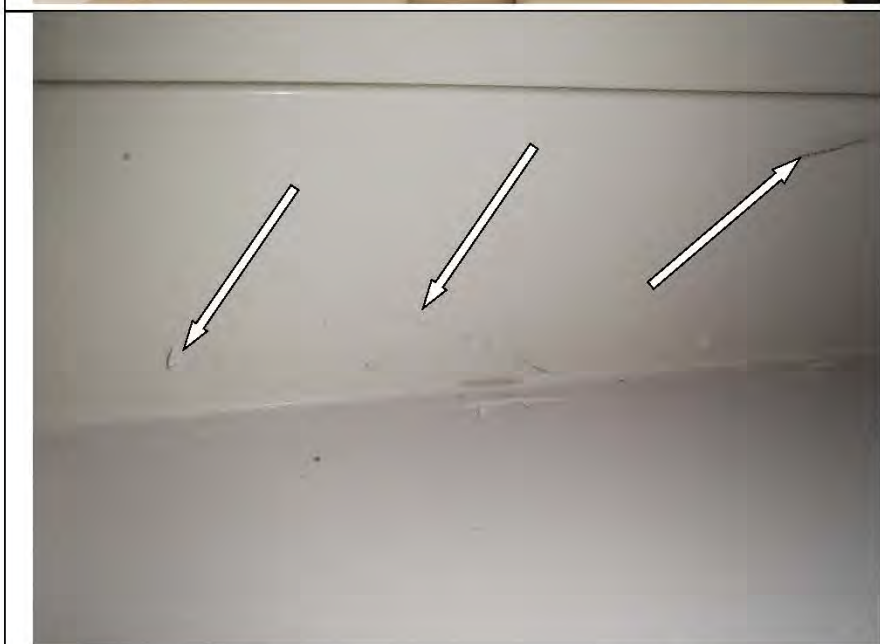
Фото №44. Царапины на профиле ПВХ оконного блока в кухне.
