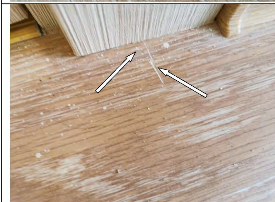
Фото №26. Царапины на поверхности ламината в коридоре.
