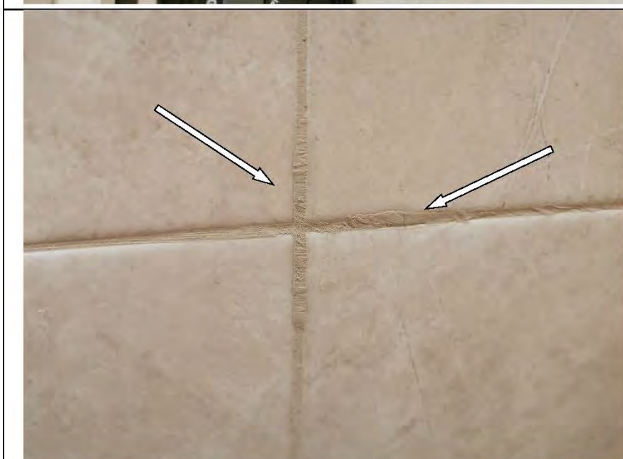
Фото №17. Некачественное выполнение затирочного шва настенной плитки в санузле.
