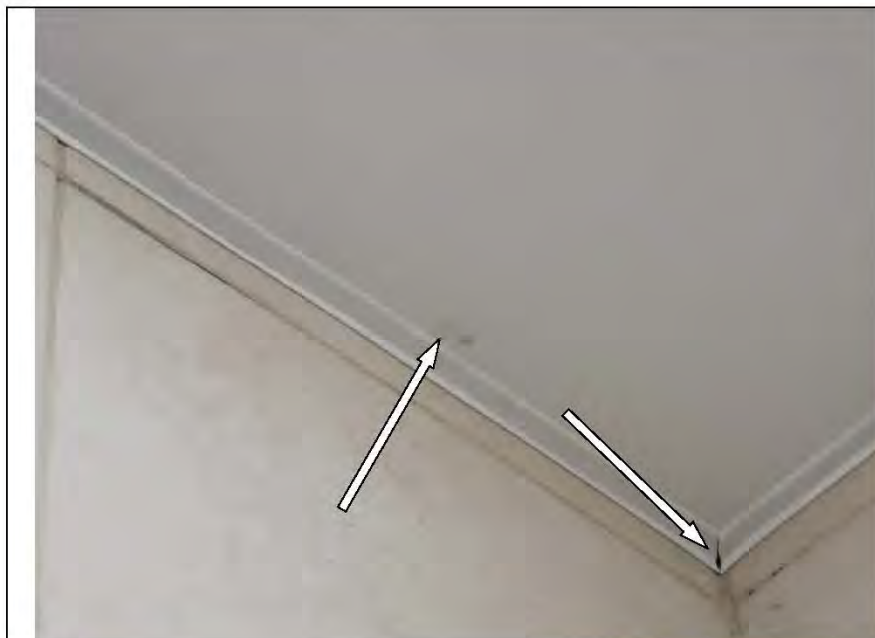
Фото №40. Загрязнение полотна натяжного потолка, дефект монтажа декоративного молдинга крепления натяжного потолка в ванной комнате.
