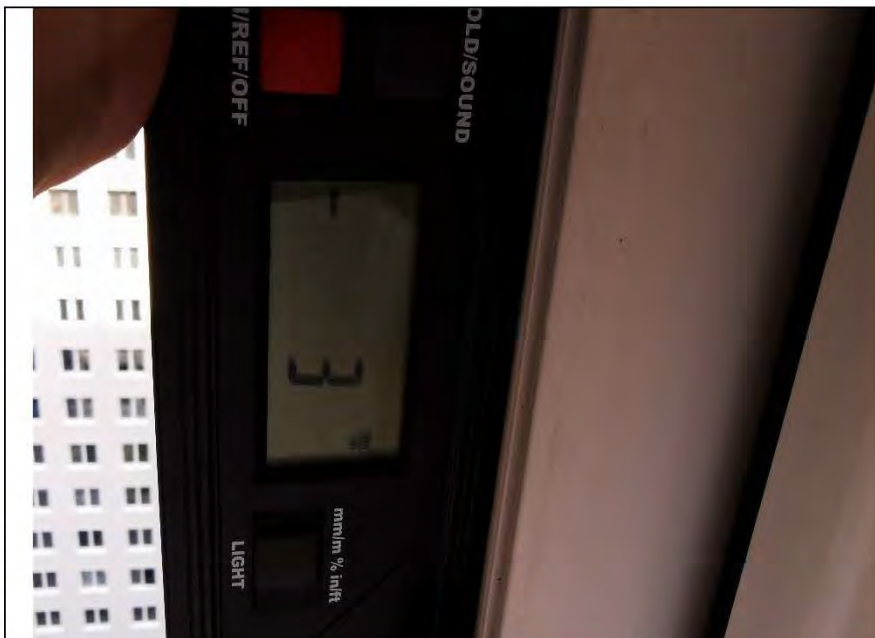
Фото №49. Отклонение оконного блока ПВХ по уровню вертикальности в спальне.
