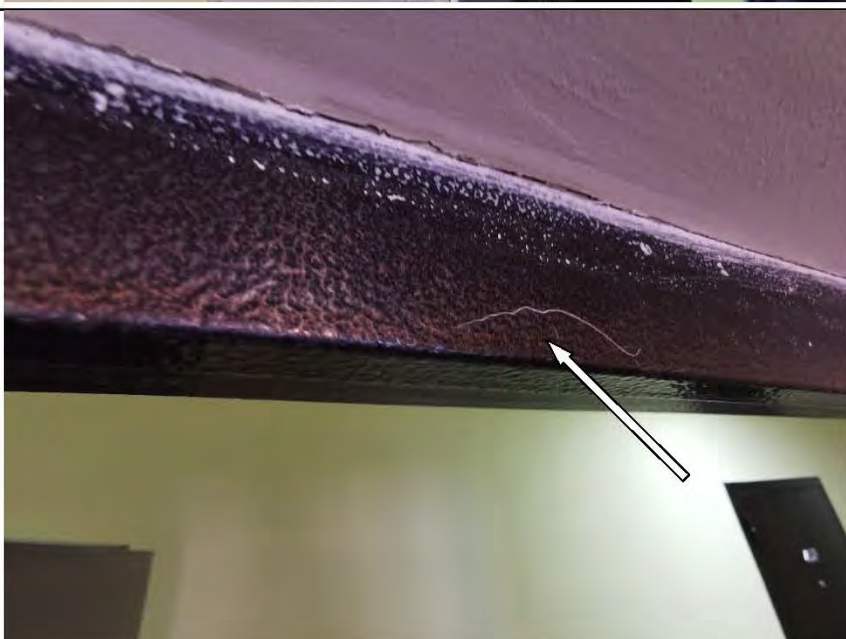
Фото №63. Царапины на коробе входного дверного блока.
