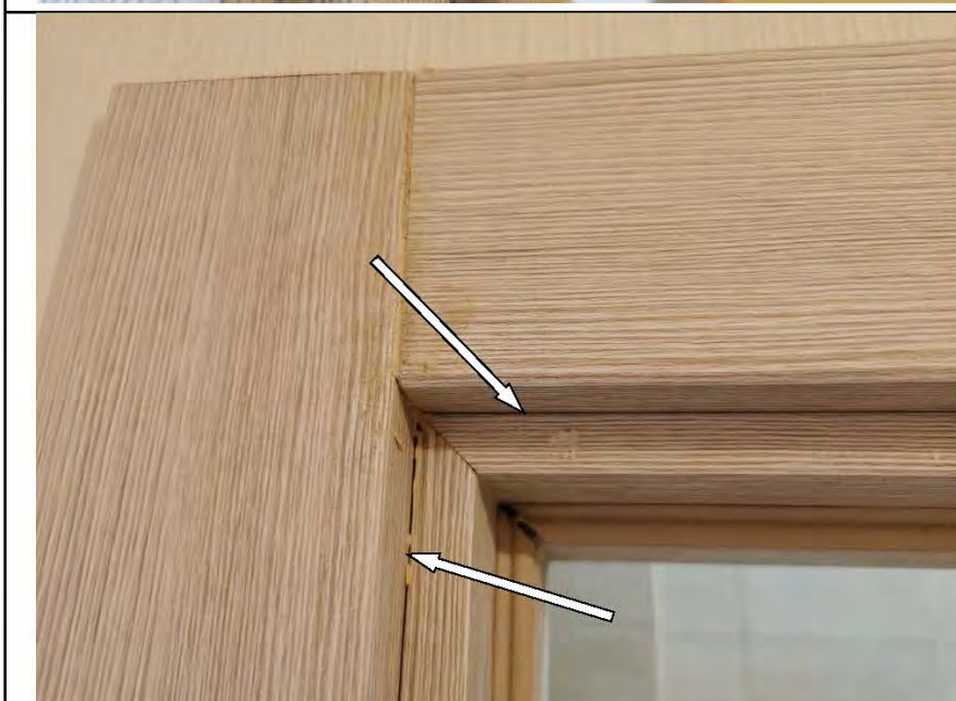
Фото №56. Ненадежное соединение элементов дверного блока в ванной комнате.
