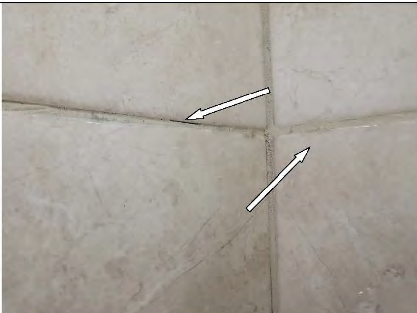
Фото №19. Некачественное выполнение затирочного шва настенной плитки в ванной комнате.
