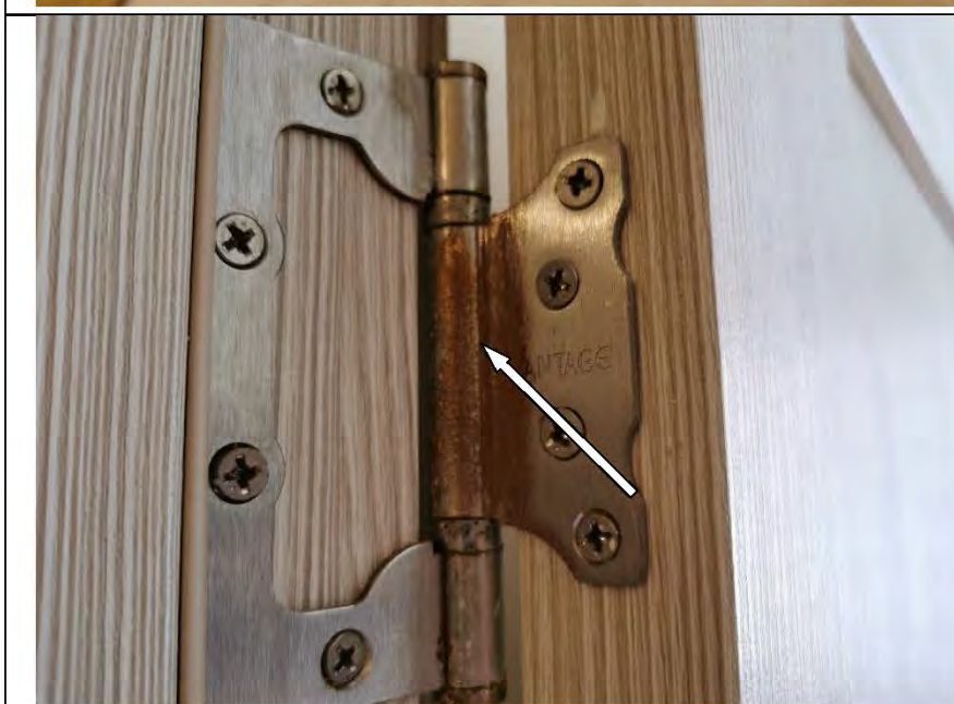
Фото №60. Коррозия на поверхности фурнитуры деревянного дверного блока в спальне.
