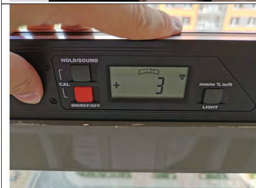
Фото №50. Отклонение металлического оконного блока по уровню горизонтальности на лоджии.
