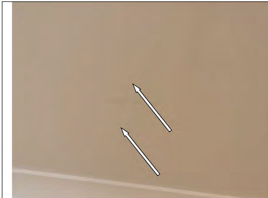
Фото №34. Некачественное окрашивание потолка в кухне.
