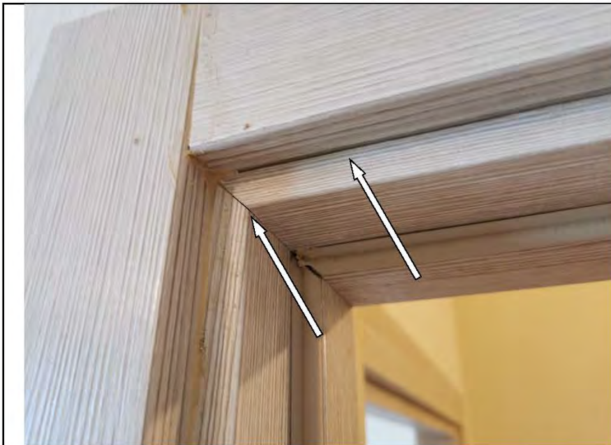
Фото №55. Ненадежное соединение элементов дверного блока в кухне.
