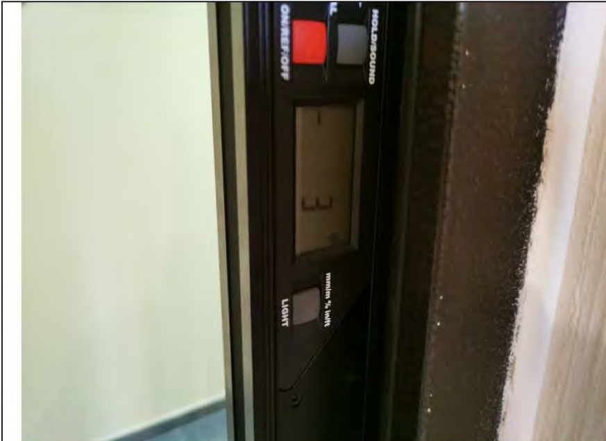
Фото №64. Отклонение коробки входного дверного блока составляет.
