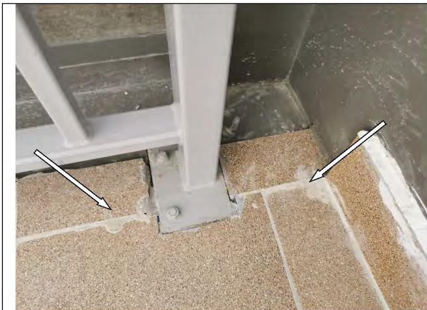
Фото №31. Загрязнение напольной керамической плитки затирочным составом в лоджии.
