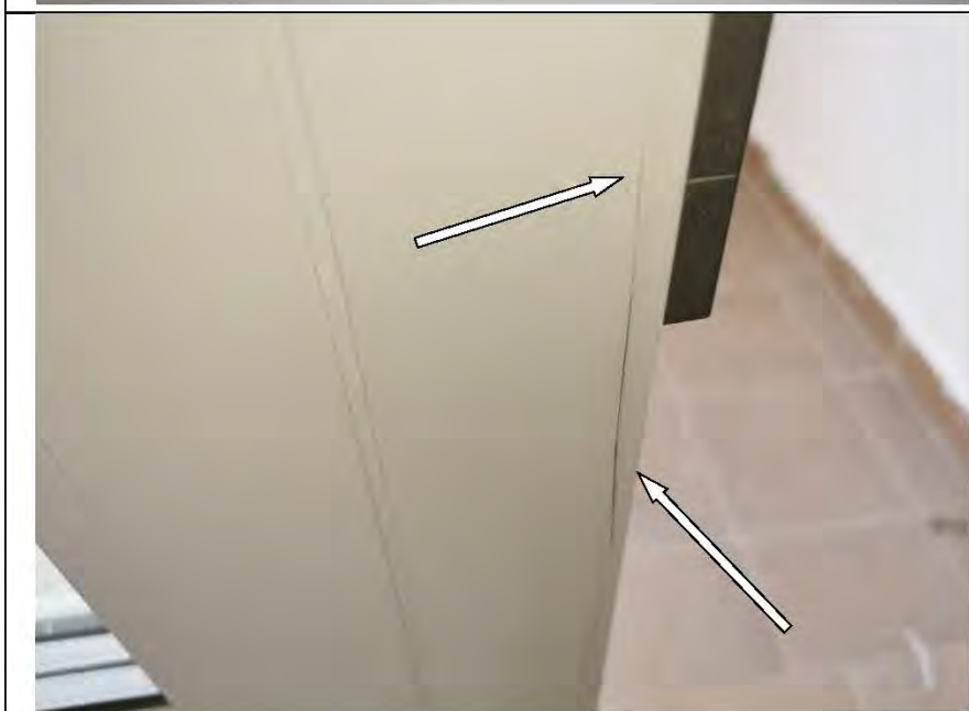
Фото №45. Царапины на профиле ПВХ дверного блока в кухне.
