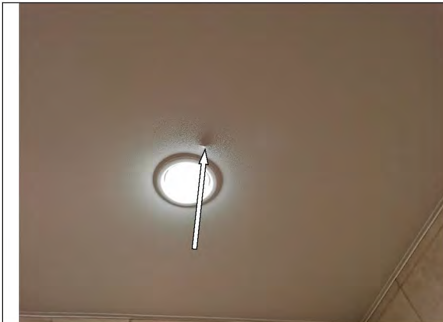
Фото №37. Видны закладные детали на полотне натяжного потолка в санузле.
