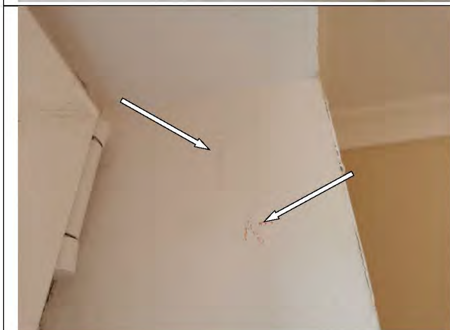
Фото №41. Окрашивание откосов оконного блока ПВХ выполнено не качественно в кухне.
