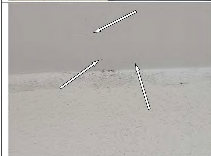
Фото №36. Некачественное окрашивание потолка в лоджии.
