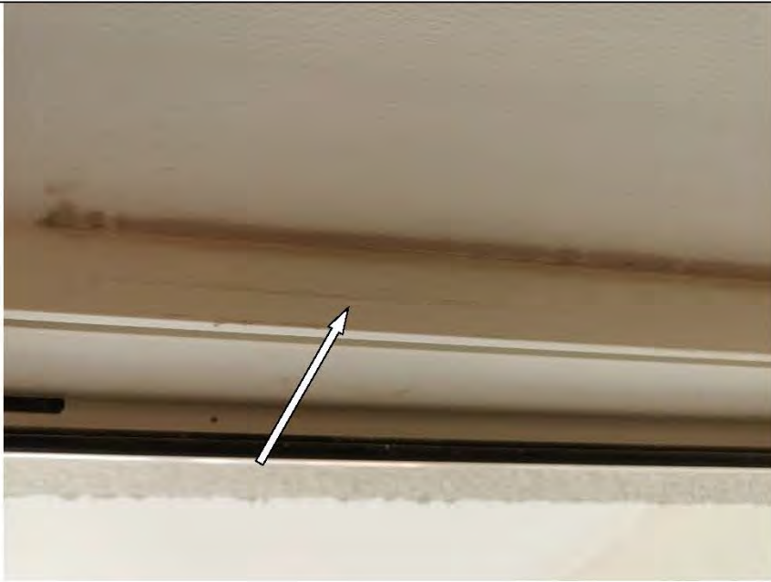
Фото №46. Царапины на профиле ПВХ оконного блока в кухне.
