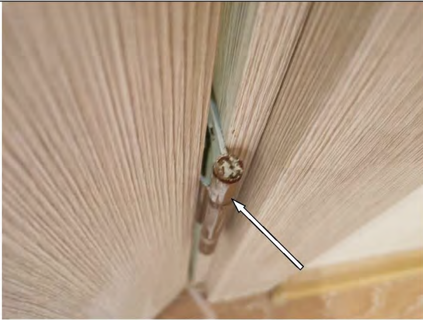
Фото №61. Коррозия на поверхности фурнитуры деревянного дверного блока в спальне.
