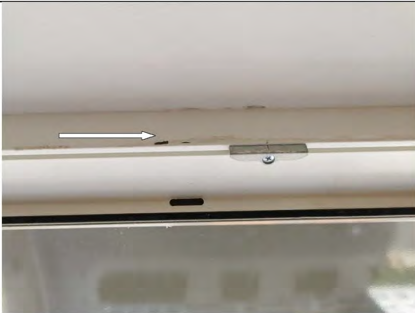
Фото №47. Царапины на профиле ПВХ оконного блока в спальне.
