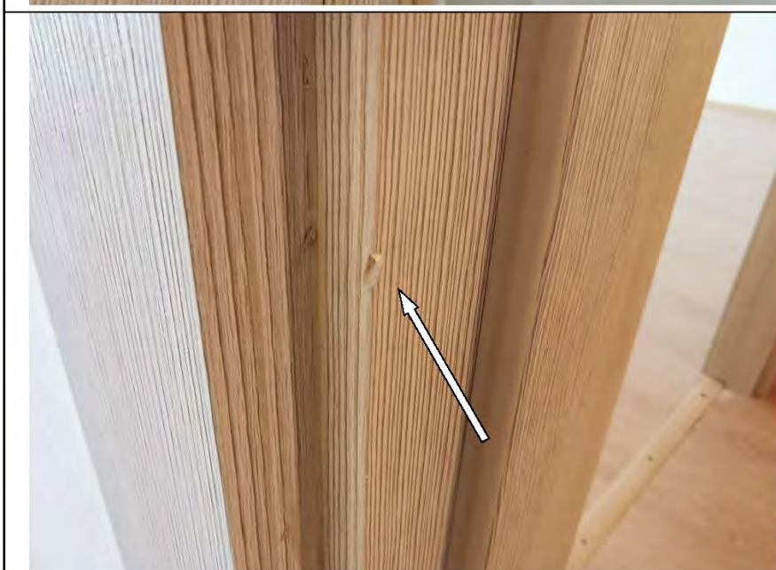
Фото №57. Скол на коробке дверного блока в кухне.
