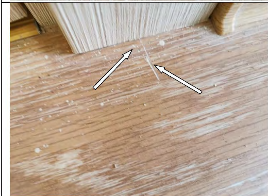
Фото №26. Царапины на поверхности ламината в коридоре.
