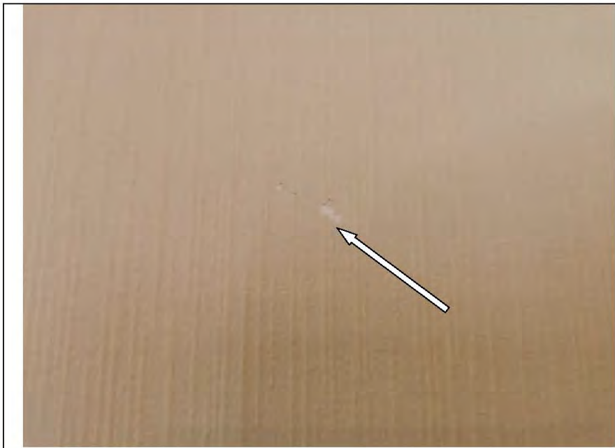
Фото №13. Потертости обойного полотна в спальне.
