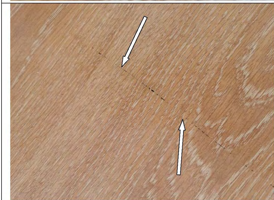
Фото №27. Царапины на поверхности ламината в спальне.
