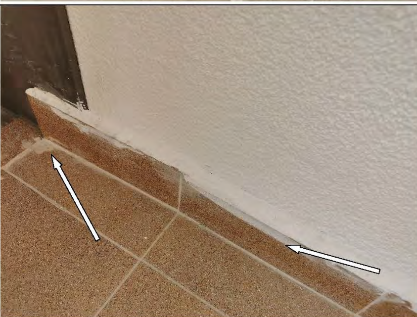
Фото №30. Загрязнение напольной керамической плитки затирачным составом в лоджии..
