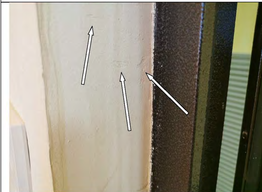
Фото №65. Окрашенные откосы входного дверного блока выполнены с дефектами.
