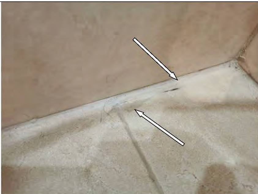
Фото №28. Загрязнение напольной керамической плитки затирачным составом в санузле.
