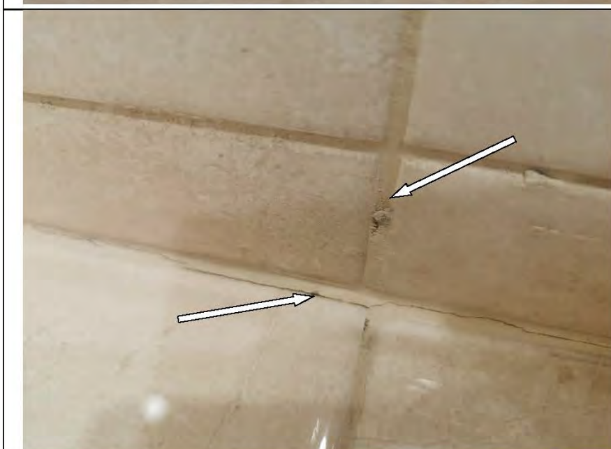
Фото №18. Некачественное выполнение затирочного шва настенной плитки в ванной комнате.
