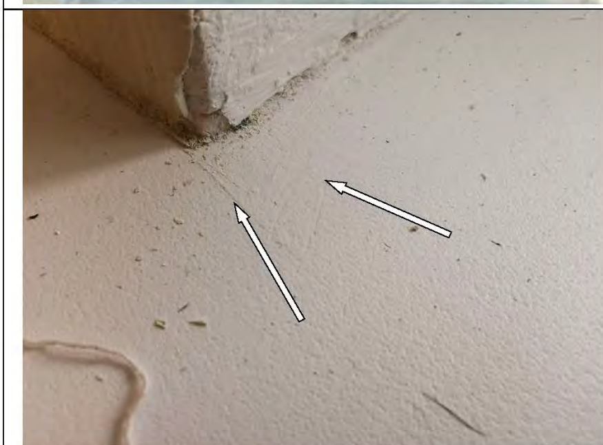
Фото №51. Царапины на лицевой поверхности подоконной доски оконного блока ПВХ в кухне.
