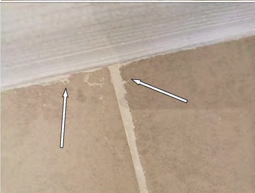
Фото №29. Загрязнение напольной керамической плитки затирачным составом в кухне.
